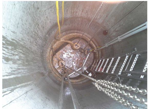
Foto (Gemeinde): Speiseöle in einem Pumpwerk der Kläranlage Weitersfelden
